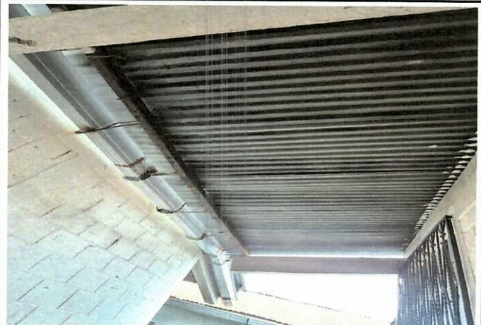
Foto 2: La muestra de esta fotografía confirma que hace falta el cambio total del techo de las aulas y bodegas
