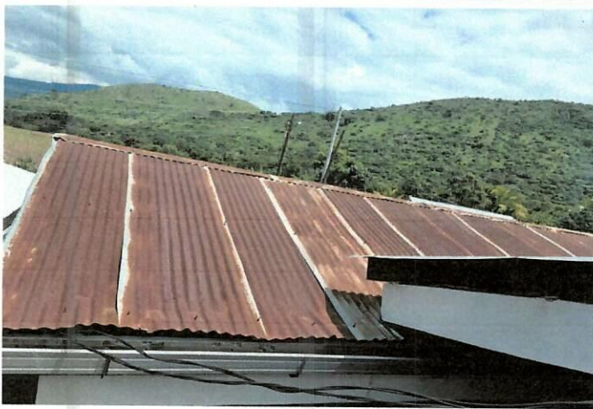
Foto 1: Esta evidencia muestra la depreciación del techo de estas aulas
